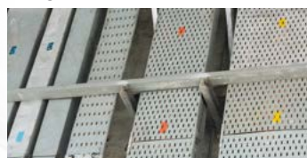
Kabelgoten en electrisch materiaal
